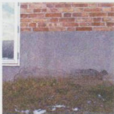
Skade på sokkel
