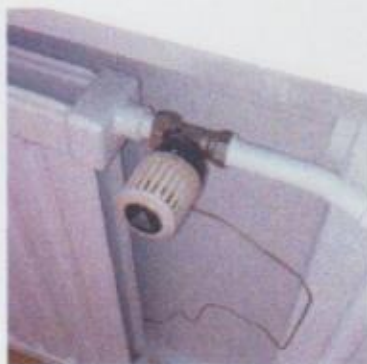
Gl. radiator og termostat
