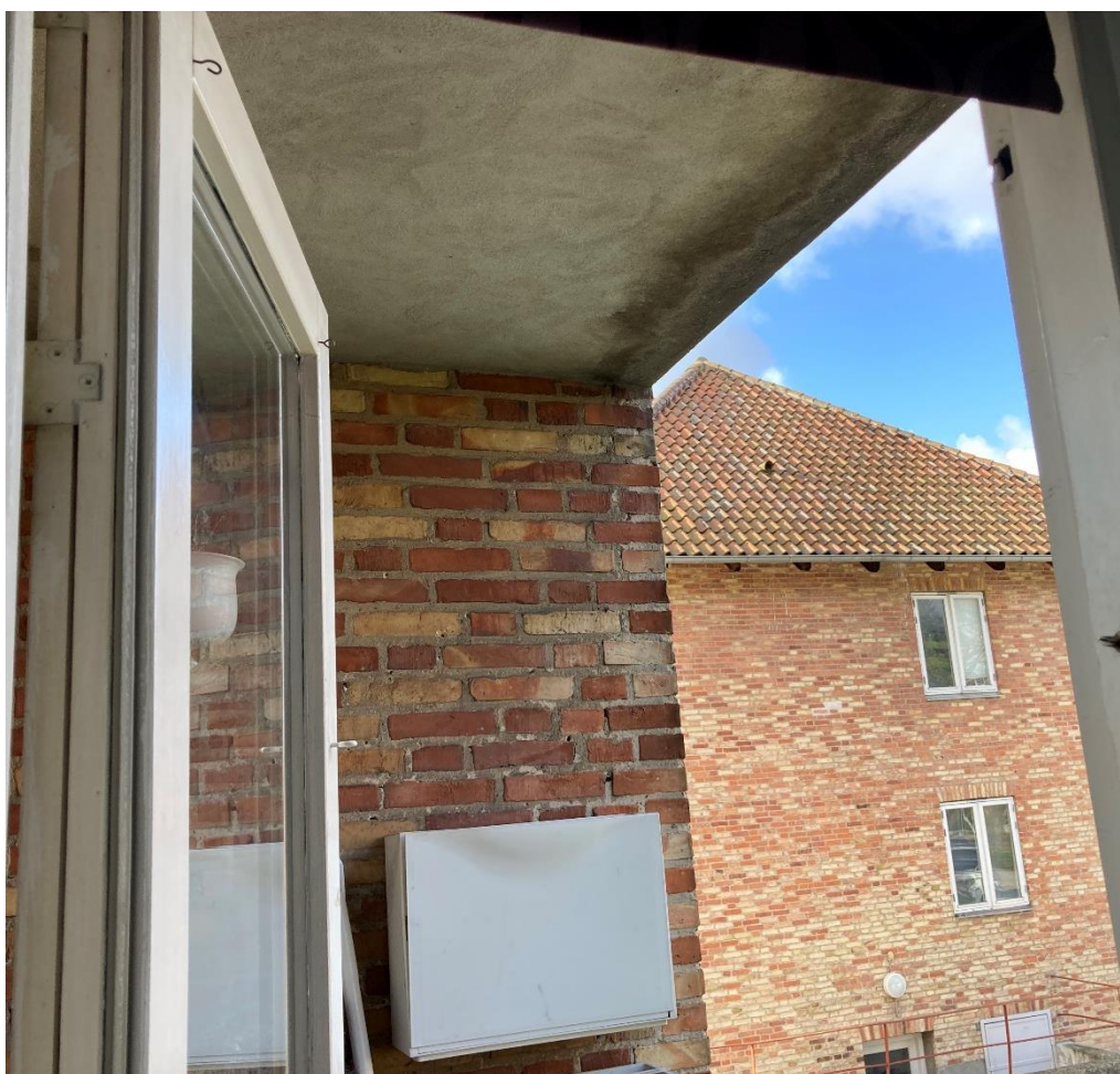
Figur 1: Misfarvninger som vurderes at være fugt. Anden side af væg, har synlige misfarvninger som vurderes at være skimmelvækst.
